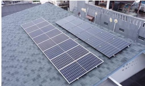
Gambar 1. Pembangkit Listrik Tenaga Surya
