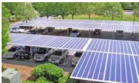
Gambar 4. PLTS (Pembangkit Listrik Tenaga Surya) [9]
