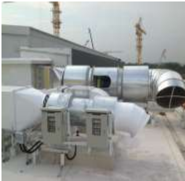
Gambar 1. Outlet Exhaust Fan Pada Industri [7].
