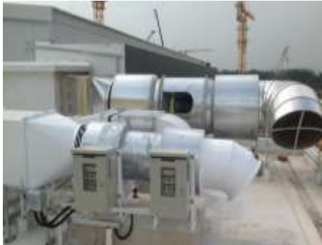
Gambar 2. Outlet Exhaust Fan Pada Industri [11]
