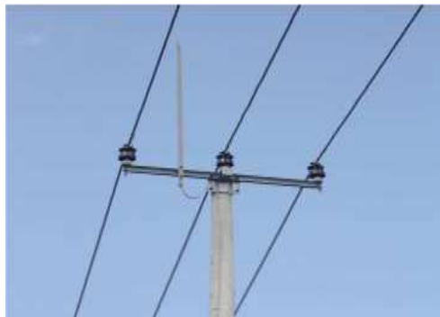
Gambar 2 Sistem Spike yang di pasang di lokasi Penyulang Buduk.
