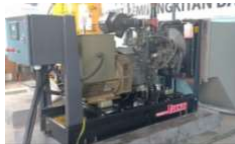
Gambar 2. Genset di di PLTD-G PT Indonesia Power Bali
