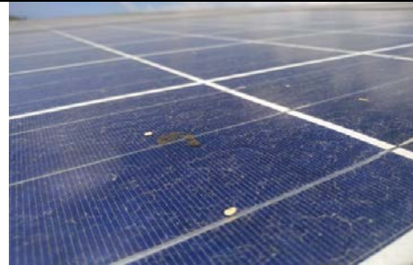
Gambar 16. Shading Akibat Kotoran yang Menempel Pada Modul Surya [5]
