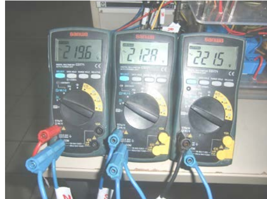
Gambar 7. Contoh pengukuran tegangan masing masing fasa menggunakan multimeter
