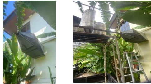
Gambar 7. Wind Tunnel Terpasang pada ducting dan PLTB
