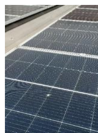
Gambar 11. Soiling Sistem PLTS On-Grid 463,25 kWp di Perusahaan Farmasi
