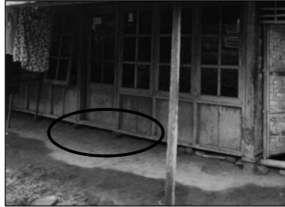
Gambar 19. Jarak antara dinding dengan lantai rumah
