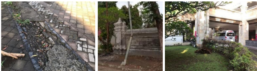
a. Paving rusak
