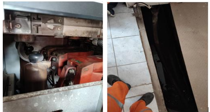
Gambar 1. Temuan Kondisi Korona pada Kubikel di Lapangan
