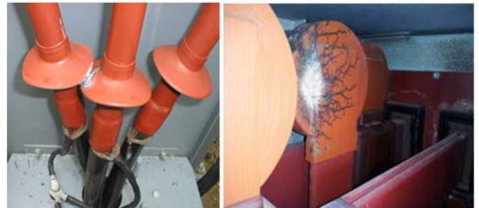
Gambar 3. Efek Korona pada Terminasi Kubikel
