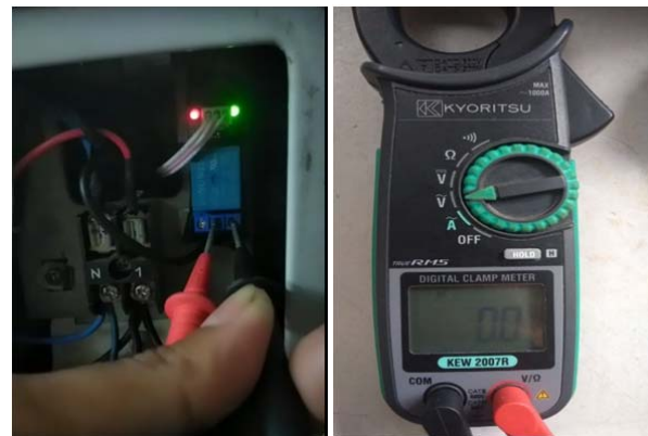
Gambar 11: Pengujian Pada Modul Relay Ketika Kompresor Rusak
