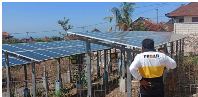
Gambar 6: Sistem PLTS Off-grid Desa Sekartaji kapasitas 15 kWp [16]
