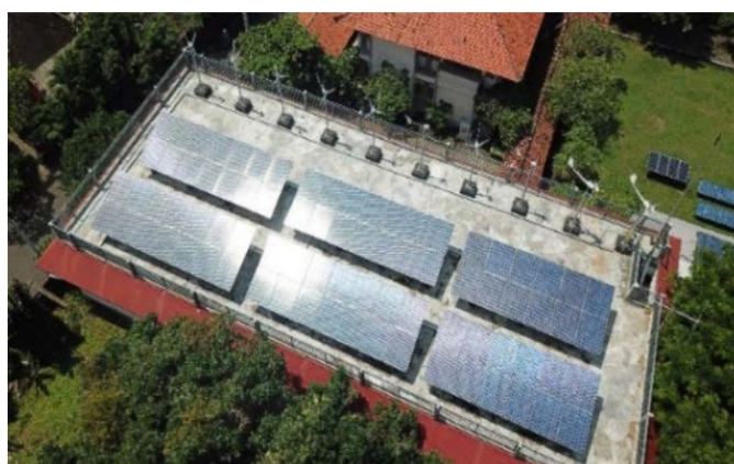
Gambar 13: PLTS smart micro grid UNUD kapasitas 26,4 kWp [14]
