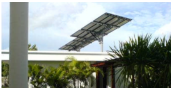
Gambar 3: Sistem PLTS Nirwana Villas Gianyar kapasitas 2,7 kWp [10]
