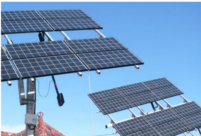
Gambar 2: Sistem PLTS Nusa Penida kapasitas 16,6 kWp [10]
