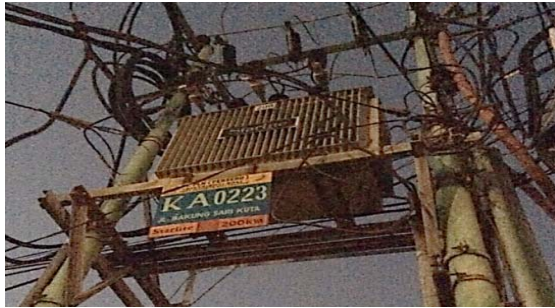
Gambar 5. Kondisi Trafo KA 0223 di jalan Kubu Anyar Legian Kuta
