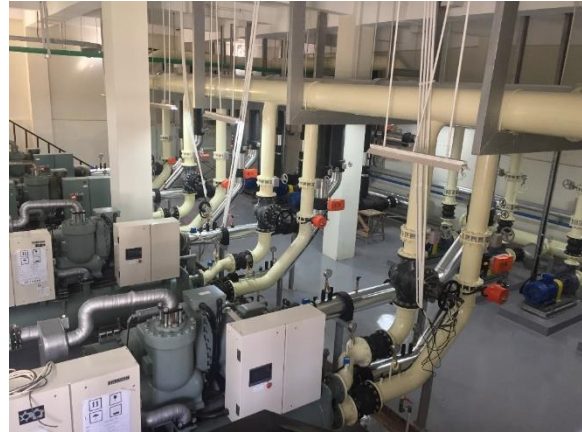
Gambar 4. Foto aktual unit chiller
