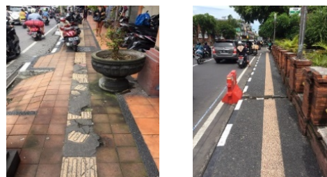
Gambar 3. Kerusakan Struktur (a), Inkonsistensi Penggunaan Material (b)
