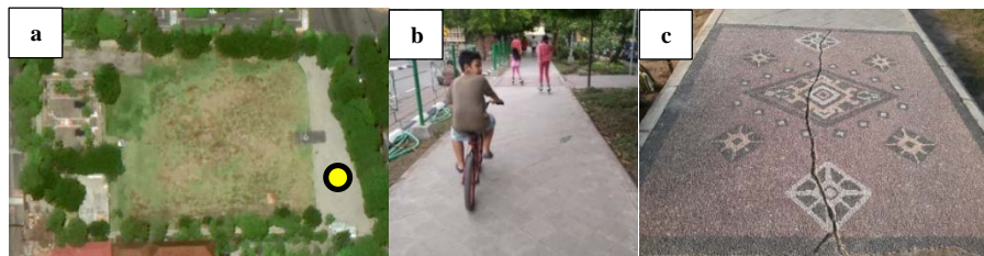
Gambar 5. Fasilitas Jogging Track (a) Pososo Jogging track pada tapak (b) Aktivitas menyimpang pengunjung dan (c) Material Jogging Track retak
