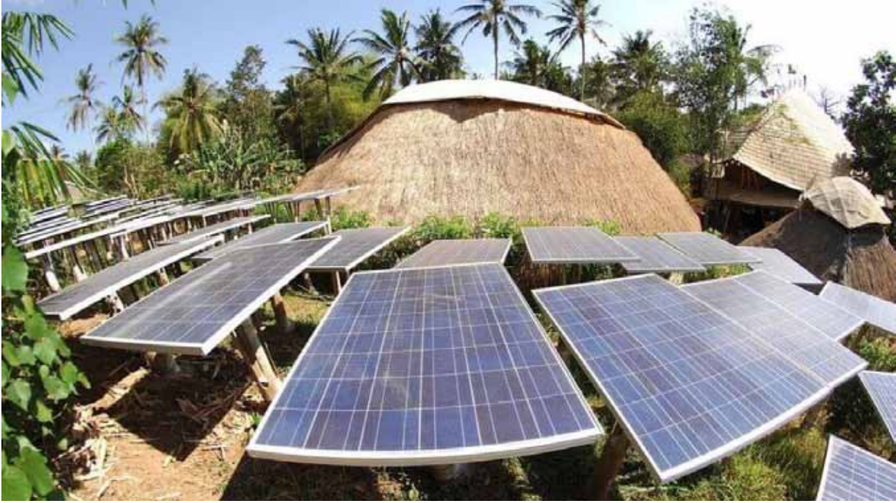
Foto 1. Instalasi listrik tenaga surya di Green School, Bali (Foto: Tirka Widanti).
