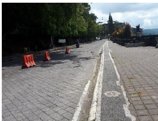
Gambar 2. Kondisi Jalan Rusak di Kawasan Wisata Geopark Batur
