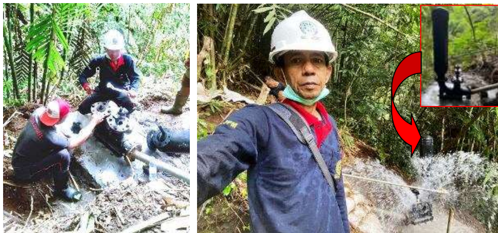
Gambar 3.1 Pemasangan dan pengoperasian instalasi sistem pompa hydrum
