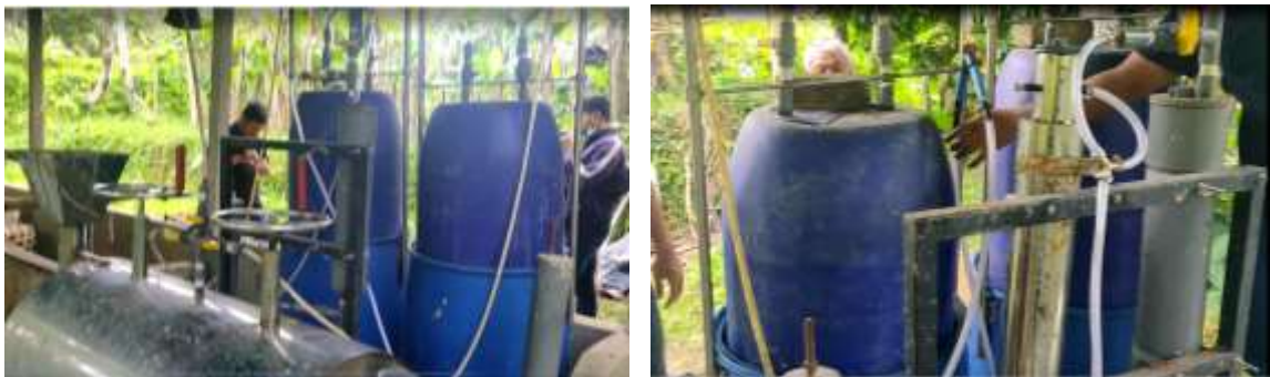
Gambar 3.2. Instalasi desulfurizer pada digester
