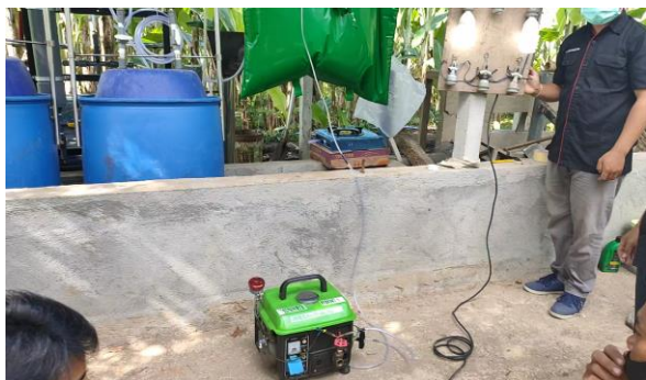
Genset biogas hasilkan listrik
