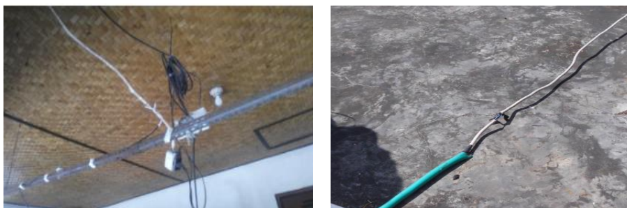
Gambar 2.1. Isolasi sambungan yang berbahaya
