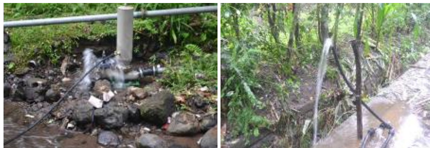
Gambar 16. Foto uji coba pompa hydram, uji kapasitas pemompaan
