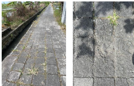
Gambar 3.2 Kerusakan pada jogging track di Subak Sembung
