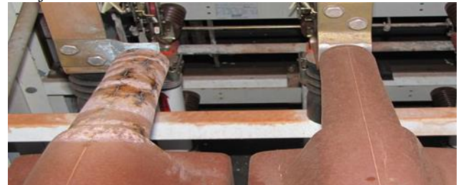
Gambar 3: Efek Korona Pada Switchgear
