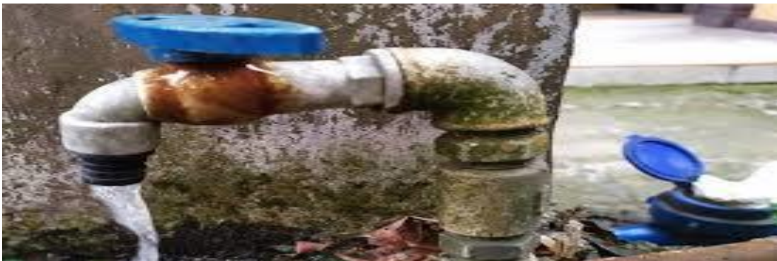
Gambar Pipa Air Masyarakat yang tidak layak digunakan karena sudah berkarat
