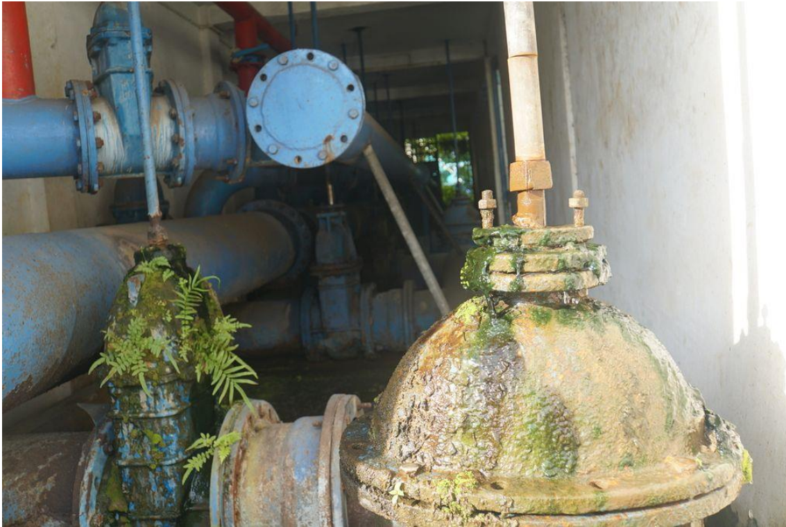
Gambar Pipa Air PDAM yang sudah berkarat
