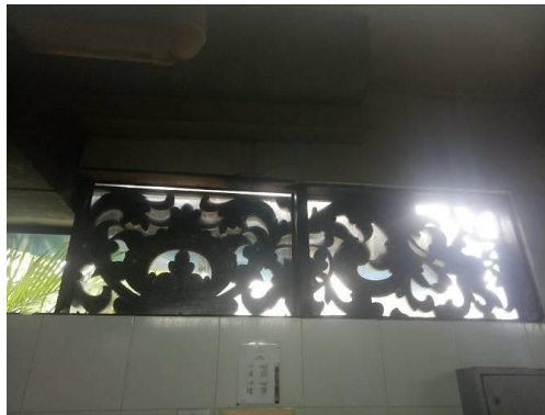
Gambar 8. Ventilasi Kitchen Sumber: Dokumentasi Pribadi, 2021
