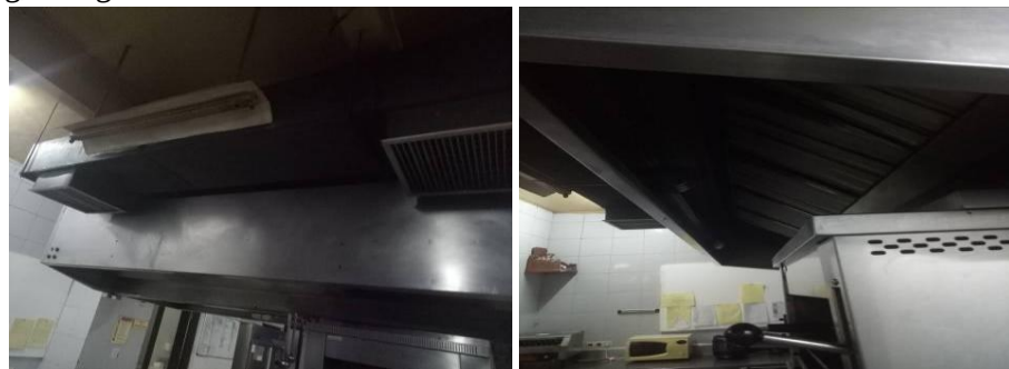
Gambar 9. Pembuangan Asap Kitchen Sumber: Dokumentasi Pribadi, 2021
