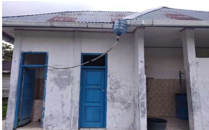
Gambar 3. Kondisi WC di Air Terjun Majajau Sumber : Dokumentasi Pribadi (2020)
