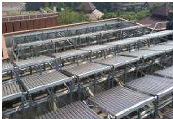
Gambar 2. Susunan tabung kolektor matahari di atap gedung perkantoran
