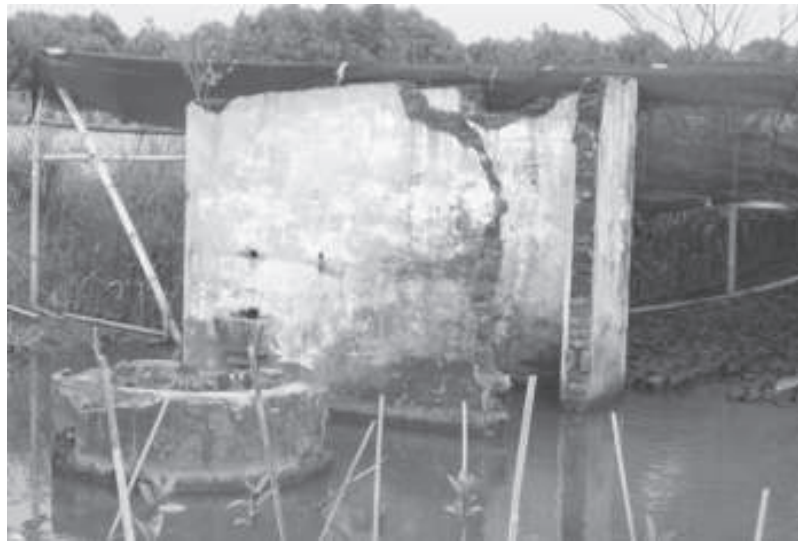
Gambar 11. Fasilitas Sumur dan Kamar Mandi yang Mengalami Genangan di Sekitarnya (Foto Nirwansyah, 2012)
