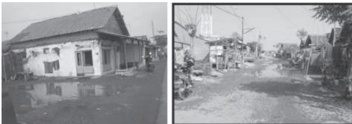
Gambar 9. A) Kerusakan bangunan rumah akibat genangan banjir, dan b) Kerusakan ruas jalan akibat genangan banjir (Foto Nirwansyah, 2012)
