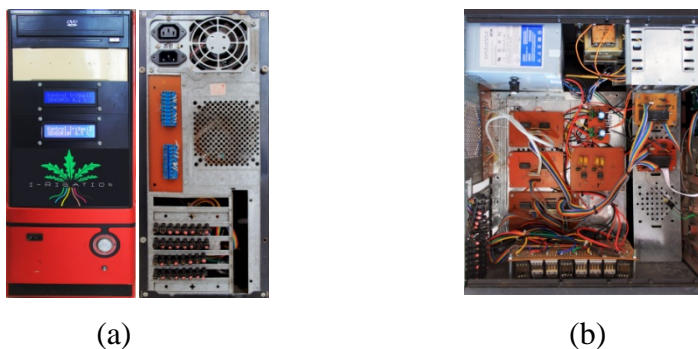
Gambar 6. (a) Kontrol otomatis tampak depan dan belakang, (b) Rangkaian sistem kontrol
